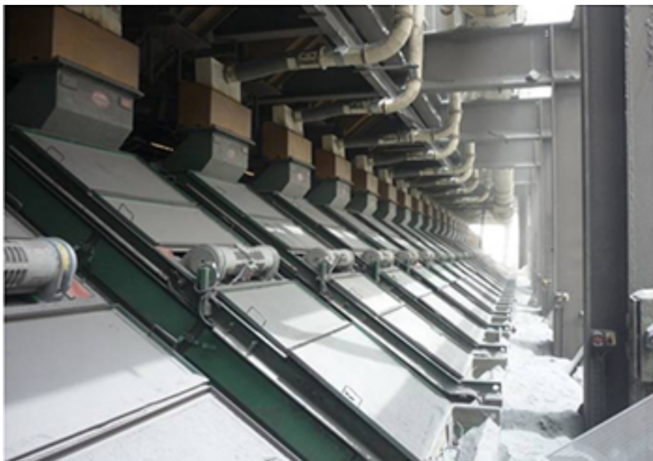
Dispositif de dépoussiérage Usine des Guelbs
