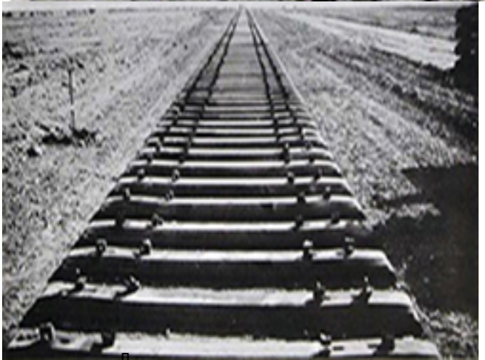
Fin des grands des travaux. Le 1er train minéralier arrive à Nouadhibou le 12 avril et le premier navire chargé de minerais mauritaniens quitte NOUADHIBOU le 27 avril 1974.
